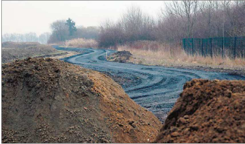
Auf der Baustelle des Reinwasserkanals fällt so viel Erdreich an, dass damit der Radparcours modelliert werden kann. Foto: ffa
